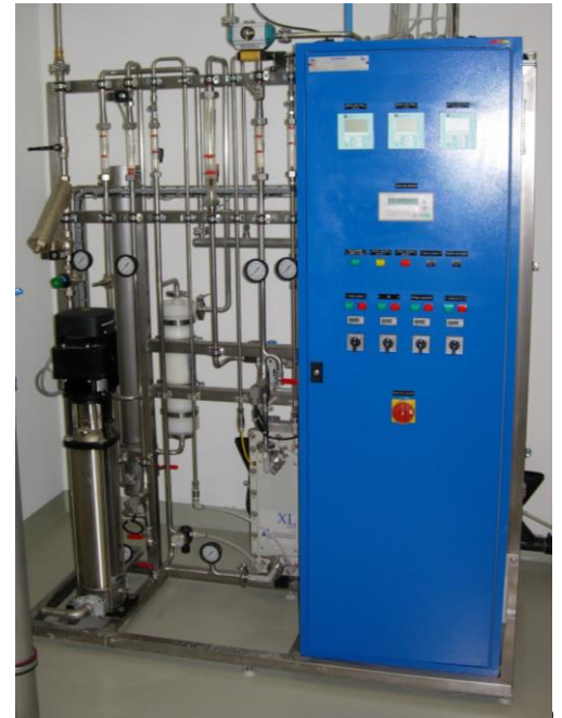
Elektraplus komplett auf einem Rahmen
