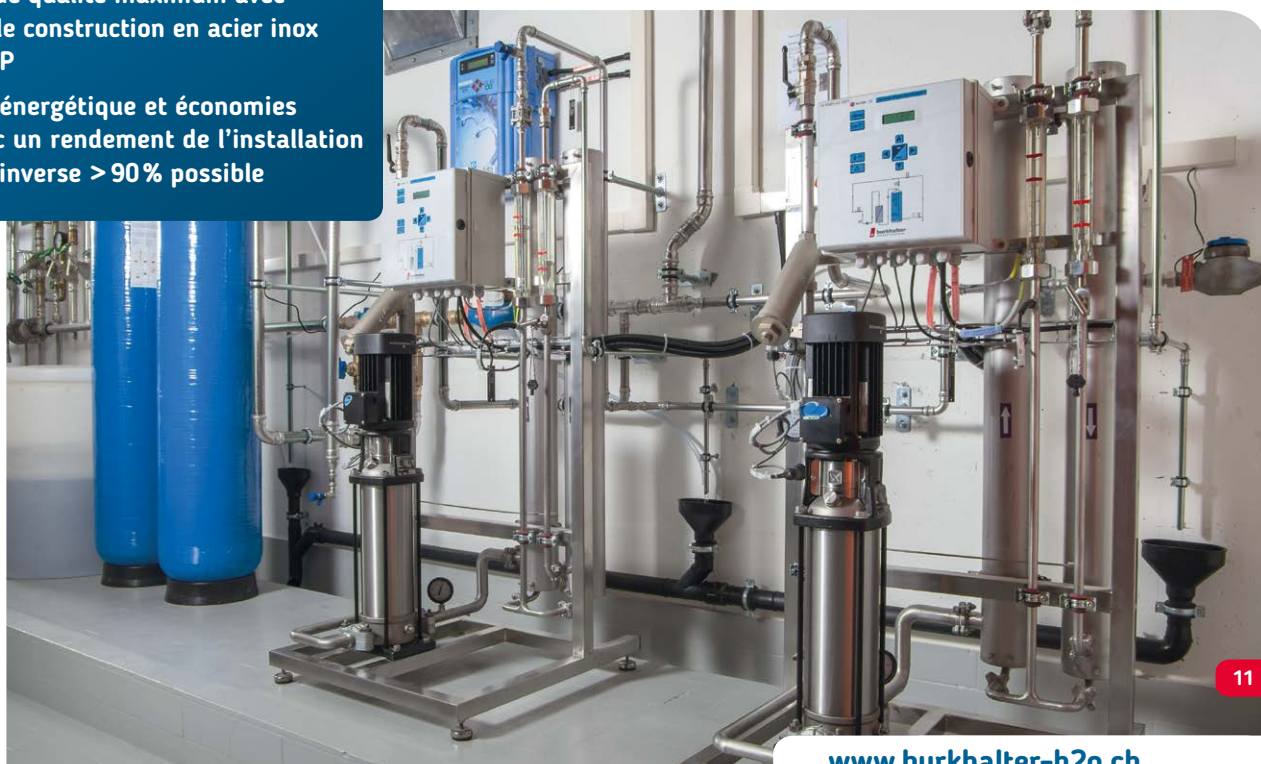
Traitement typique de l'eau dans un bâtiment par adoucissement et osmose inverse
